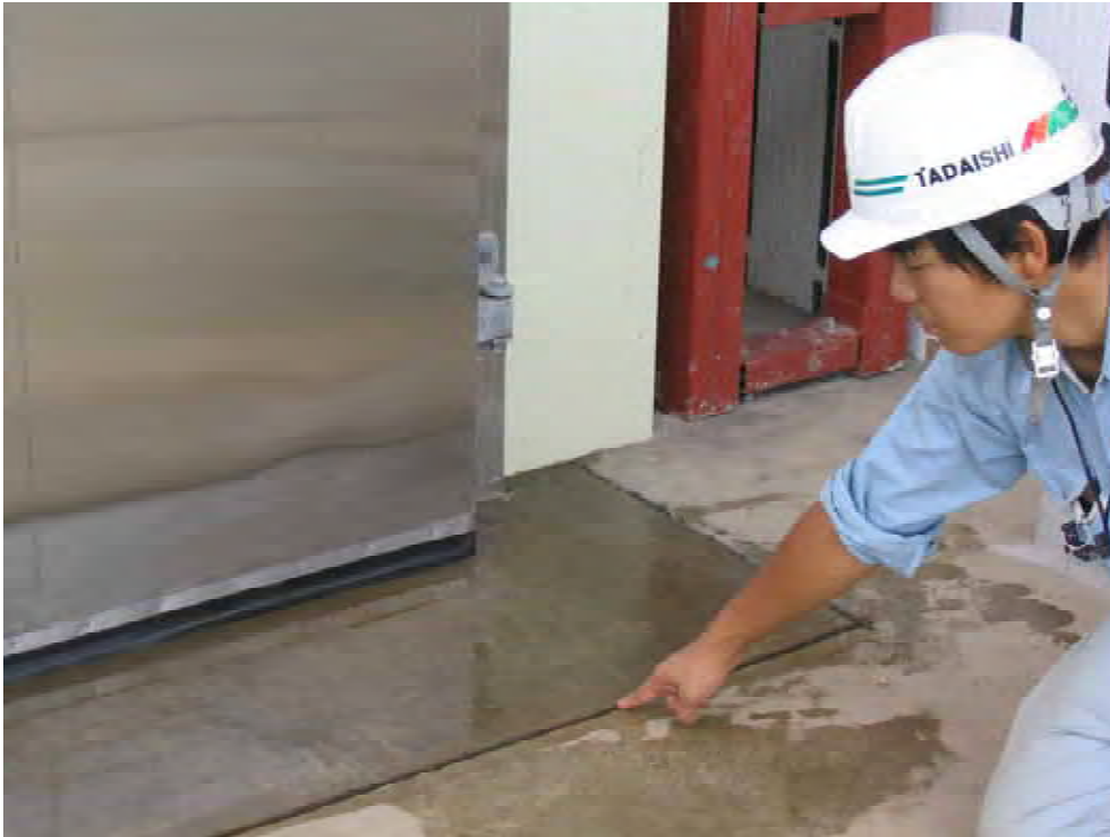
写真 3 - 4 冷凍冷蔵庫の外観の下部【冷凍冷蔵庫】
