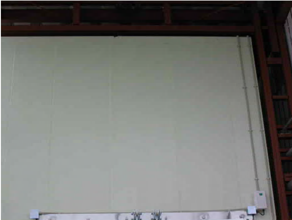
写真 3 - 2 冷凍冷蔵庫の外観の上部【冷凍冷蔵庫】
