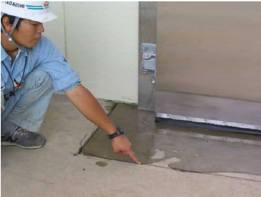
写真 3 - 5 冷凍冷蔵庫の外観の下部【冷凍冷蔵庫】
