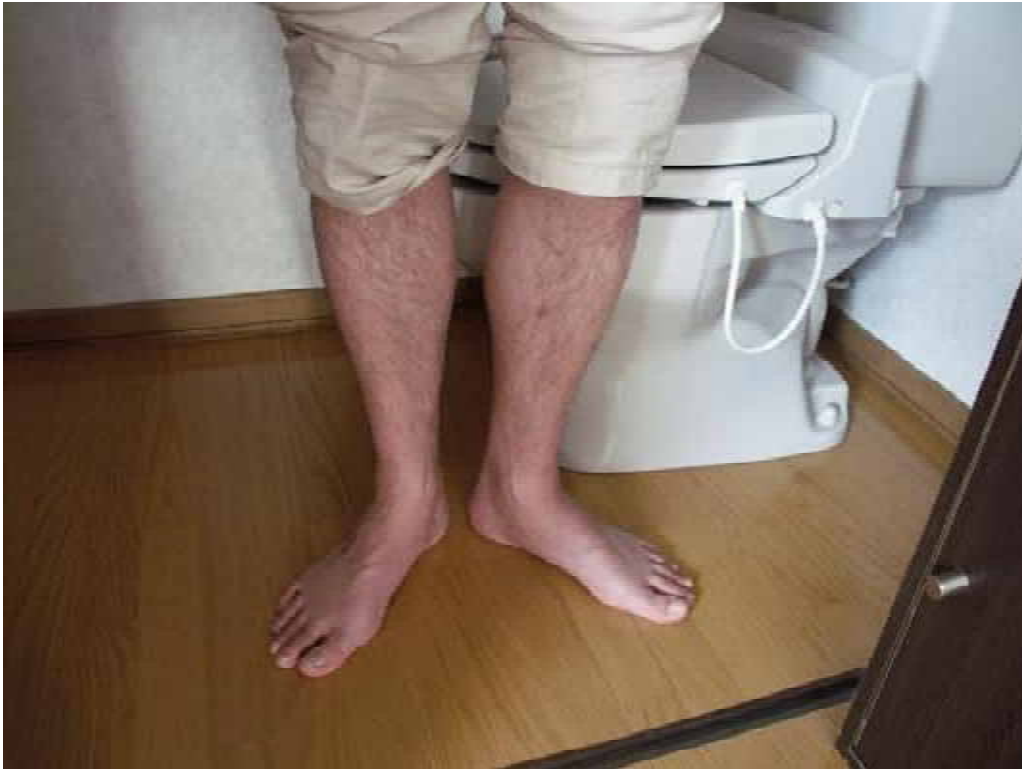
写真 2 - 2 1 階の洋室 8.6 畳と接しているトイレの床面と人の足【S 様宅】
