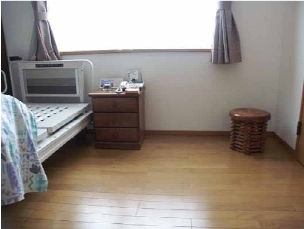
写真 1 - 7 1 階の洋室（北側）の壁・床面【A様宅】
