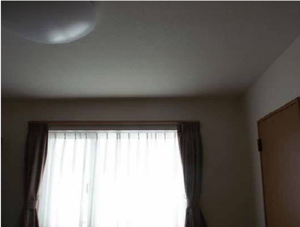
写真 1 - 9 1 階の洋室（北側）の天井面【A様宅】
