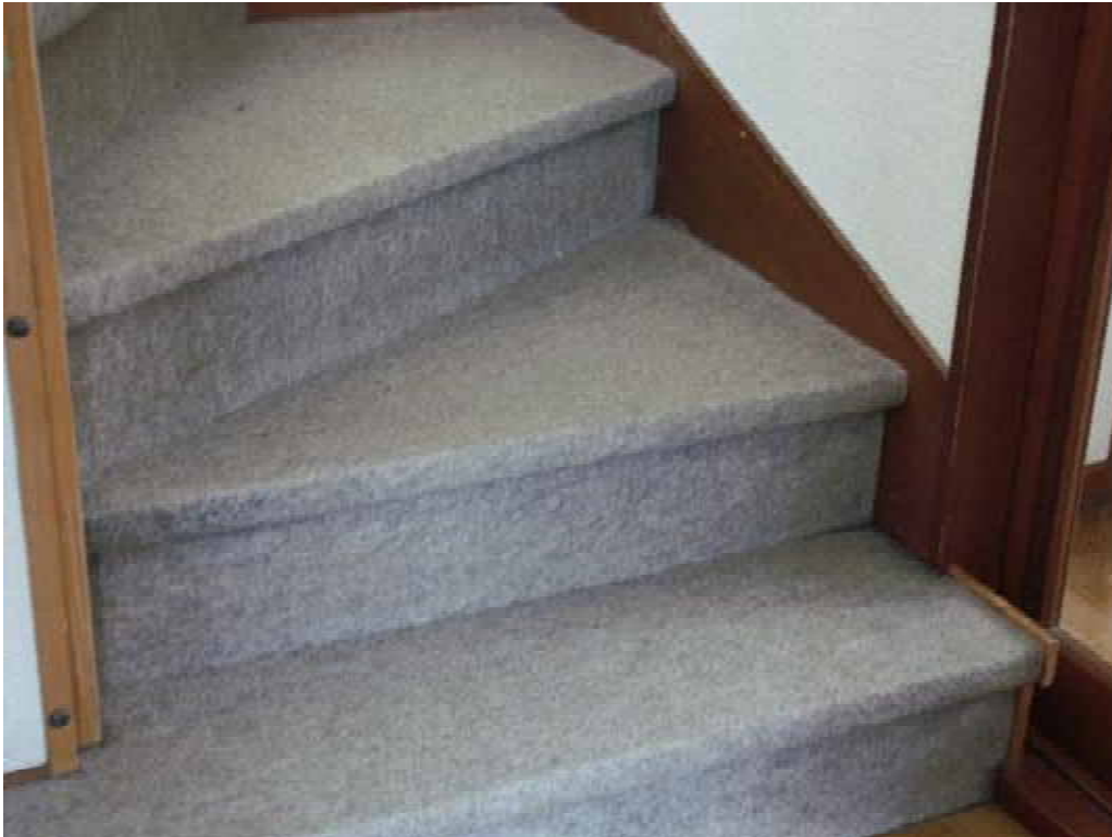
写真 3 - 6 1 階の階段室の床面【Y、T 様宅】
