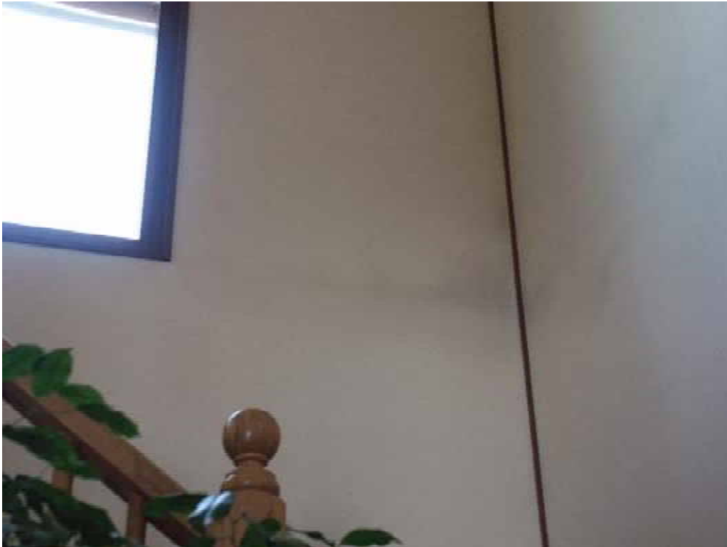
写真 3 - 7 1 階の階段室の壁面・中部【Y、T 様宅】
