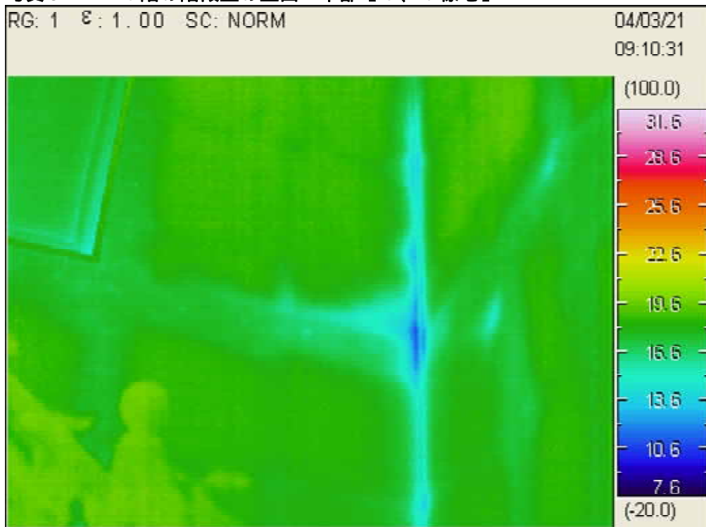
図 3 - 7 1 階の階段室の壁面・中部【Y、T 様宅】
