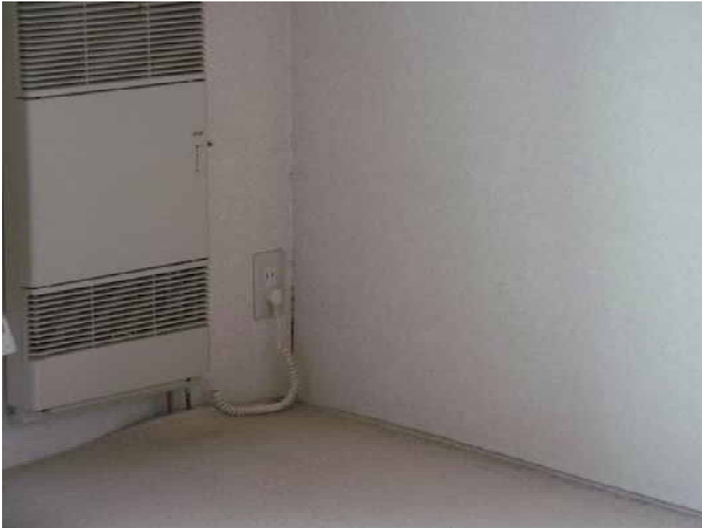
写真 4 - 6 1 階の和室の温風器付近【N 様宅】
