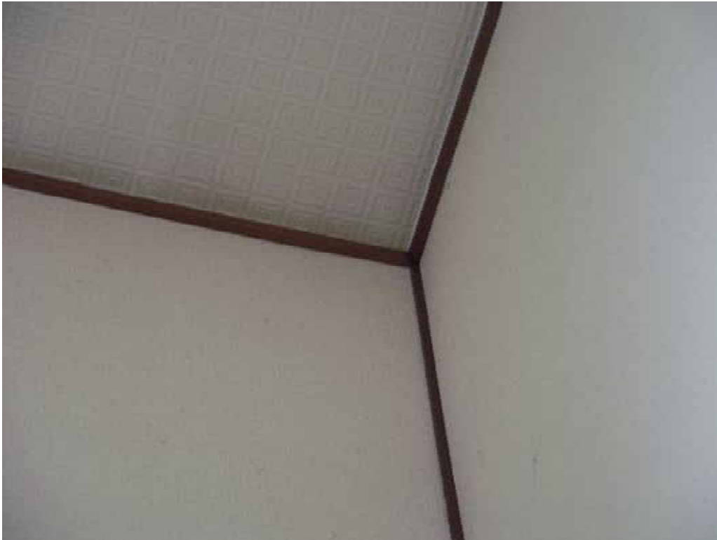
写真 3 - 8 1 階の階段室の壁面・上部【Y、T 様宅】
