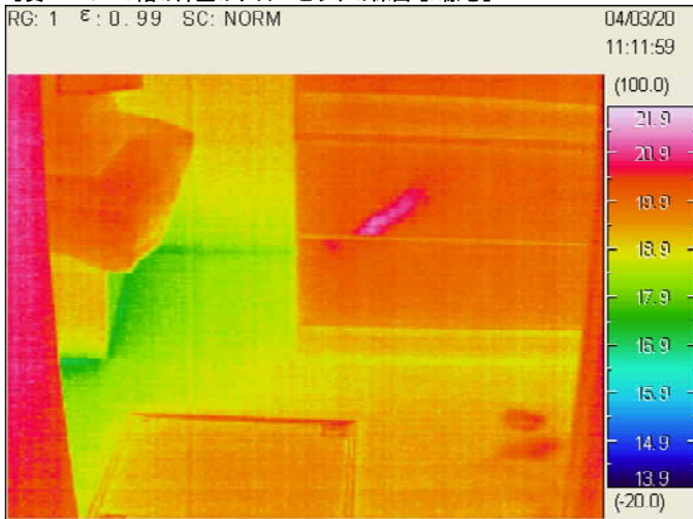
図 1 - 6 1階の洋室のクローゼットの床面【A様宅】
